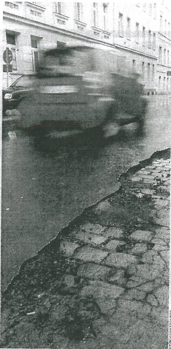
Ramponierte Straßen wie diese warten in ganz Deutschland auf eine Sanierung
